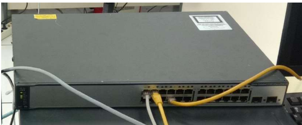
Gambar 4. 37 Switch Menuju Router-0 dan Router-1
