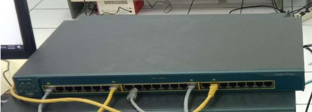
Gambar 4. 35 Switch Menuju Router-0
