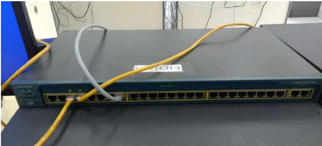
Gambar 4. 36 Switch Menuju Router-1
